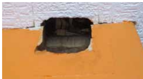
Aftrækskanal fra køkkenet. Flere af disse kanaler er lukket med aviser af beboere fordi det giver kulde-gener. Dette medfører et dårligt indeklima som er usundt og sygdomsfremkaldende.
