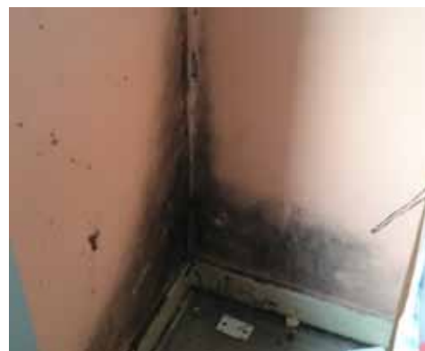
Eksempel fra Frydenspark hvor der er skimmelsvamp, som er dårligt for lungerne. Årsagen er ringe ventilation og dermed høj fugtighed i boligen
