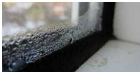
Vindue fra Frydenspark med kondens. Kondensen opstår fordi fugtigheden i boligen er for høj, som igen skyldes den dårlige ventilation og dårligt isolerende vinduer.
